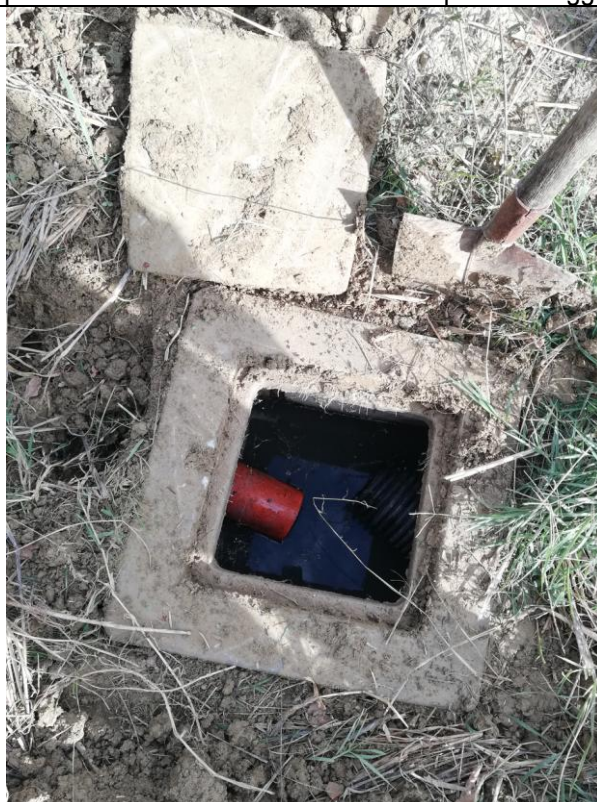
Pozzetto fiscale o post-campionamento con decantazione – Foto particolareggiata
