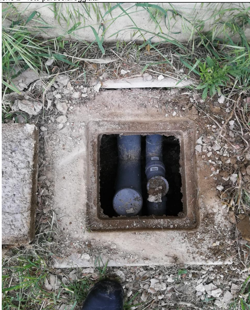
Pozzetto di Ispezione 2– foto particolareggiata
