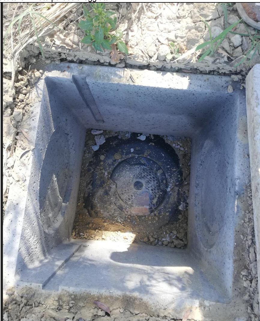
Pozzetto degrassatore – Foto particolareggiata
